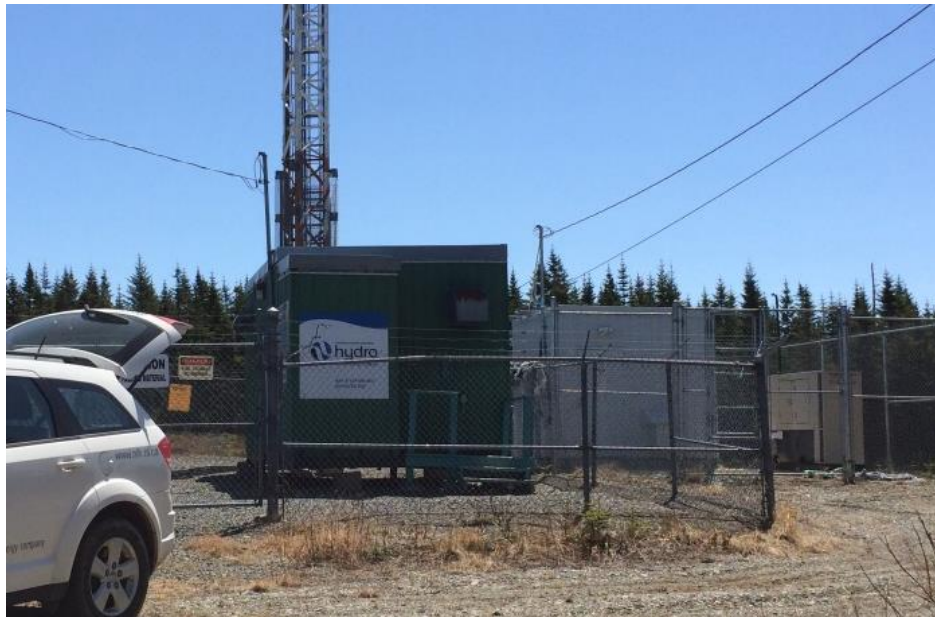
Figure 3: Bay d’Espoir Hill Telecommunications Site
